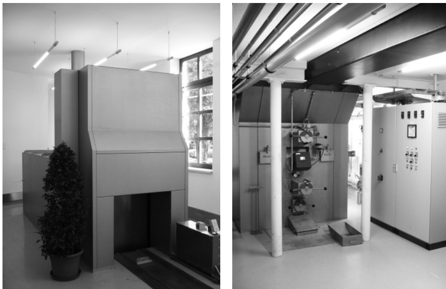
Bild 6. Ansichten des Etagenofens im Krematorium Salzburg (Oberofen im öffentlichen Einfahrbereich und Unterofen im Technikraum).
